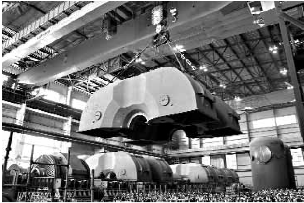
Смонтированная на Нововоронежской АЭС-2, — первая в России быстроходная (3 тыс. оборотов в минуту) мощностью 1200 МВт. Это инновационная разработка, созданная специально для энергоблоков нового поколения, которые сооружаются по проекту «АЭС-2006».
