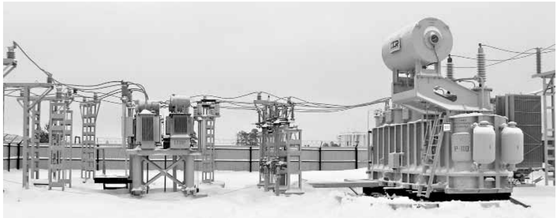
Установки БСК способствуют нормализации нагрузок на питающие линии и трансформаторы
