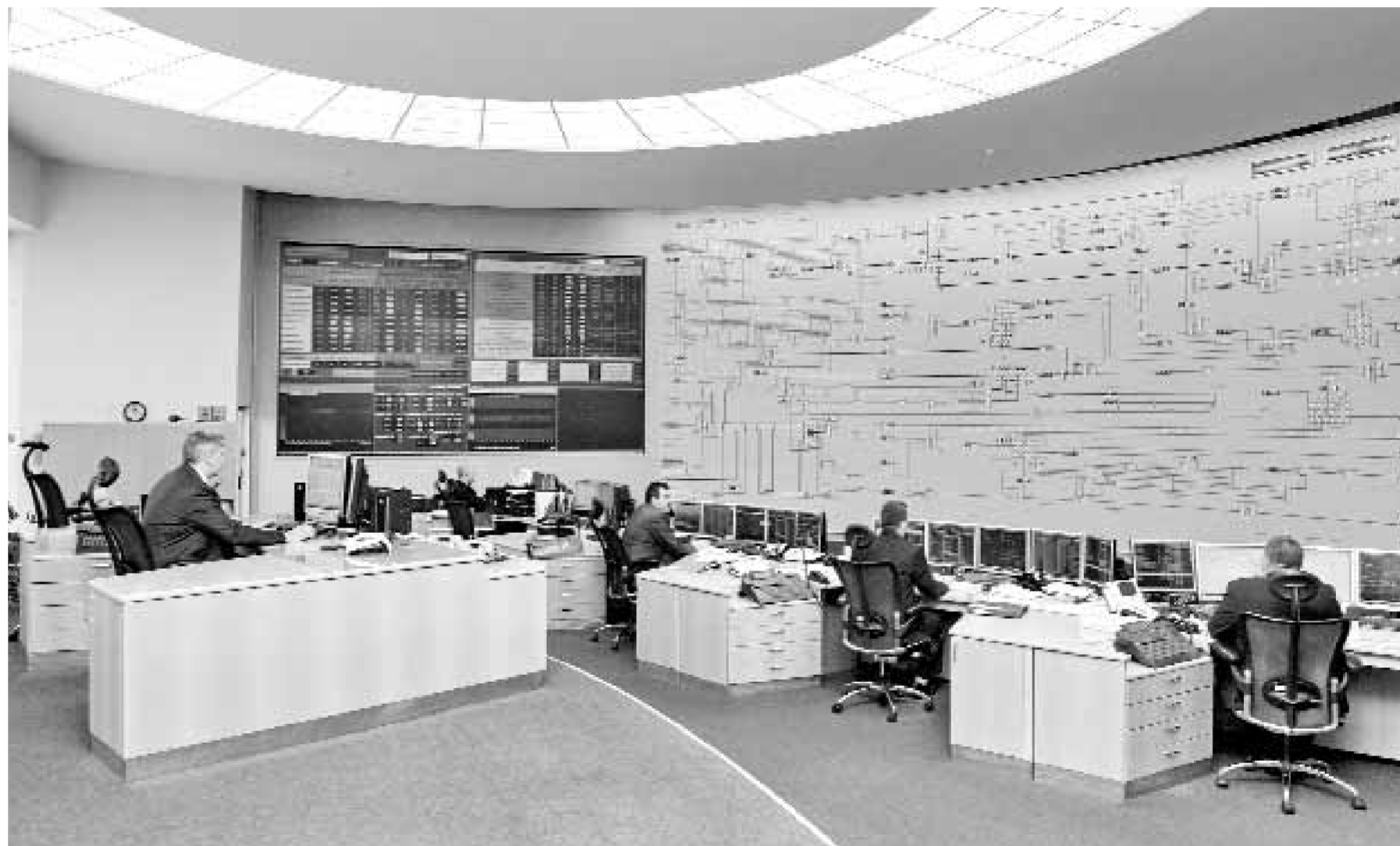
Именно с этого щита в Москве ведется управление всей Единой энергосистемой страны
