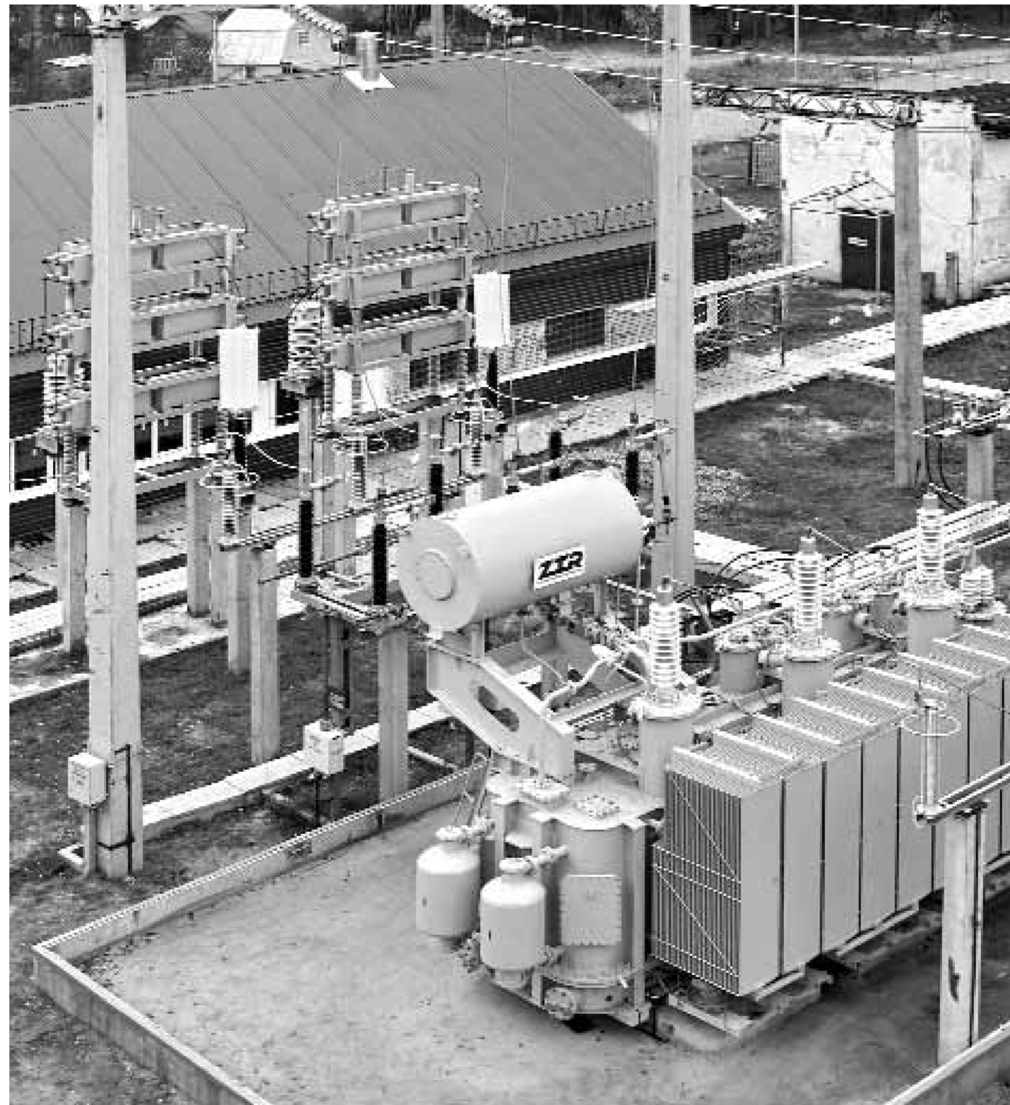
БСК-УШР на ПС 110/35/6 «Покров» — пока единственный в энергосистемах Центральной России на напряжении 110 кВ. Мощность УШР — 25 МВАр. Снижение уровня потерь электроэнергии — 6 млн кВт·ч/год. Плавное регулирование напряжения в пределах — 3-6%
