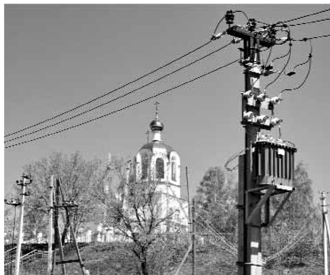
Первый этап проекта «Энергоэффективный объект» повысит качество электроснабжения села Каракулино (Удмуртская Республика). Реконструировано ТП суммарной мощностью 800 кВА. Введено ТП суммарной мощностью 1540 кВА. Установлено и заменено 249 групп учета
