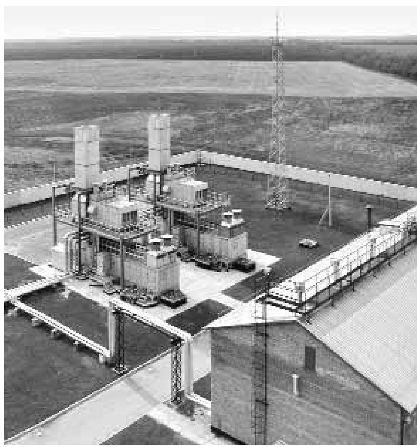
2хГТЭС-2,5 на КС «Сальская» ОАО «Газпром»
